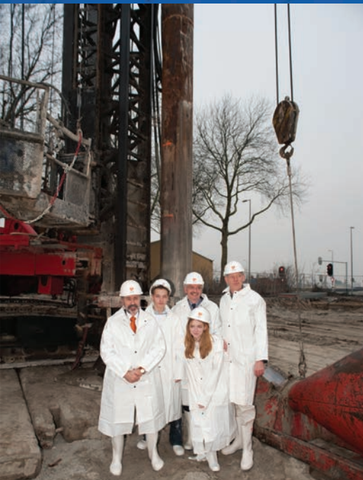
Bestuursvoorzitter van de STC-Group de heer Hietbrink met twee leerlingen en het managementteam tijdens de start van de nieuwbouw aan de Waalhaven
